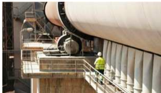
Un des fours de la Cimenterie de Bouskoura
